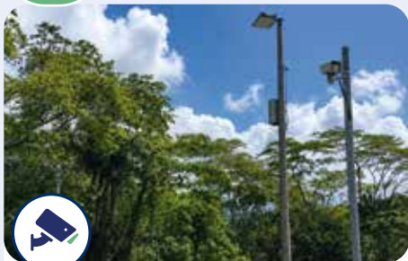
Sistema de detección electrónica con cámaras y sensores instalados a ambos lados de la vía.
