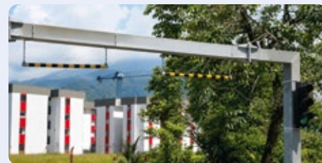
Pórtico de gálibo con semáforo y tubos colgantes.
